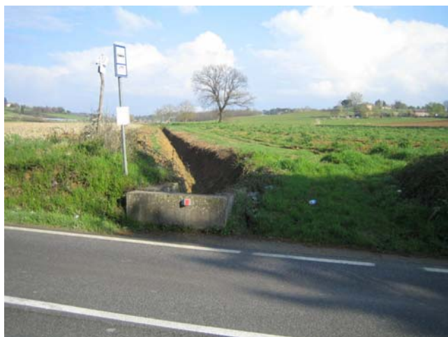
Foto 3 - Vista dell'arrivo della scolina sulla SR 73 in prossimità del Pod. Casa al Piano
